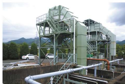
山口市浄水センター水処理設備
