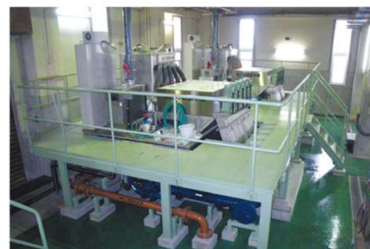
和気町和気浄化センター汚泥処理設備
