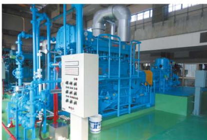
阿津ポンプ場雨水ポンプ機械設備
