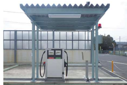
野殿バイオディーゼル燃料給油施設
