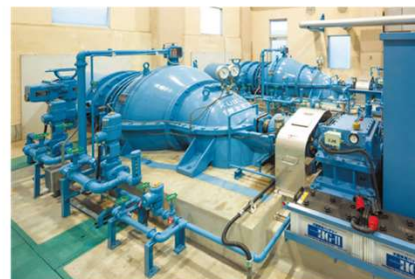
服部排水機場ポンプ設備
