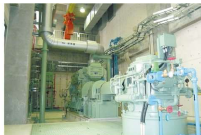
瀬戸雨水ポンプ場ポンプ設備
