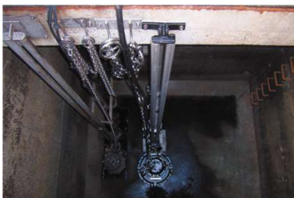
四国中央市大江汚水ポンプ場水処理設備
