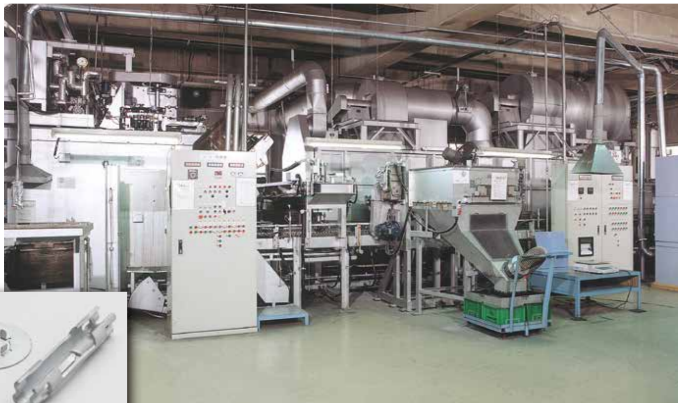
連続式ジオメット処理装置
